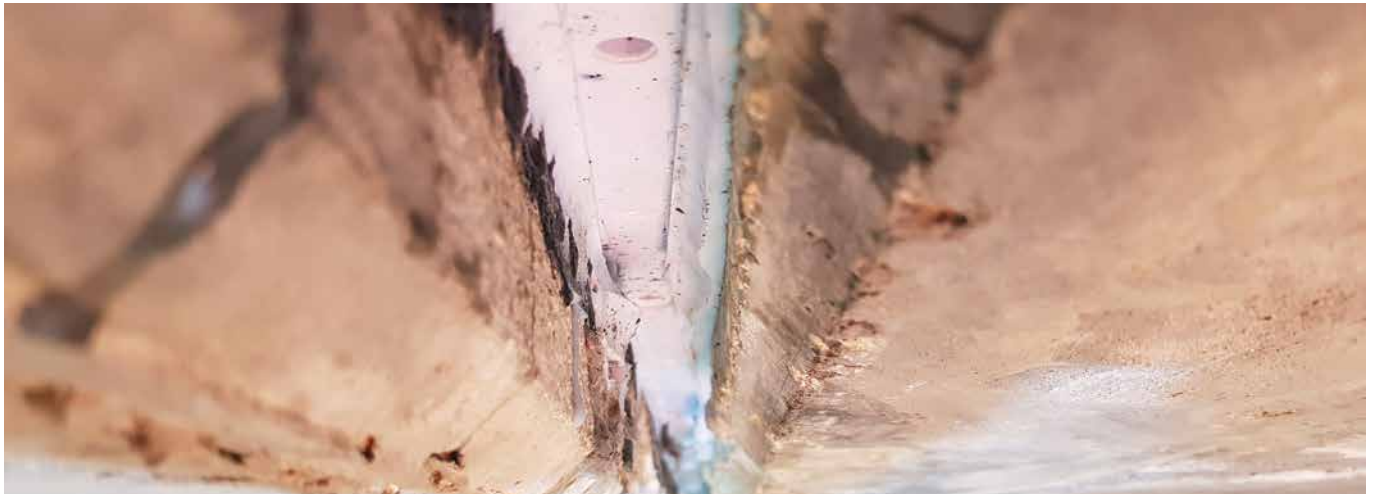
Erfolgreiche Sanierung der Fuge mit dem DESOI Quick Seal und dem Rechteck-Stahlpacker | Successful rehabilitation of the joint with DESOI Quick Seal and the rectangular steel packer
